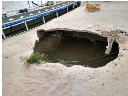
Figura 17 - Ponto de observação “P7” – Erosão na orla da Cidade.
