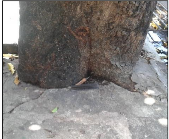
Figura 09 – Condições de sufocamento.
